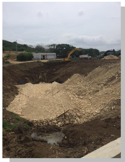
Construcción de fondo y estabilización de taludes del canal alimentador de la Ciénaga del Rincón.
